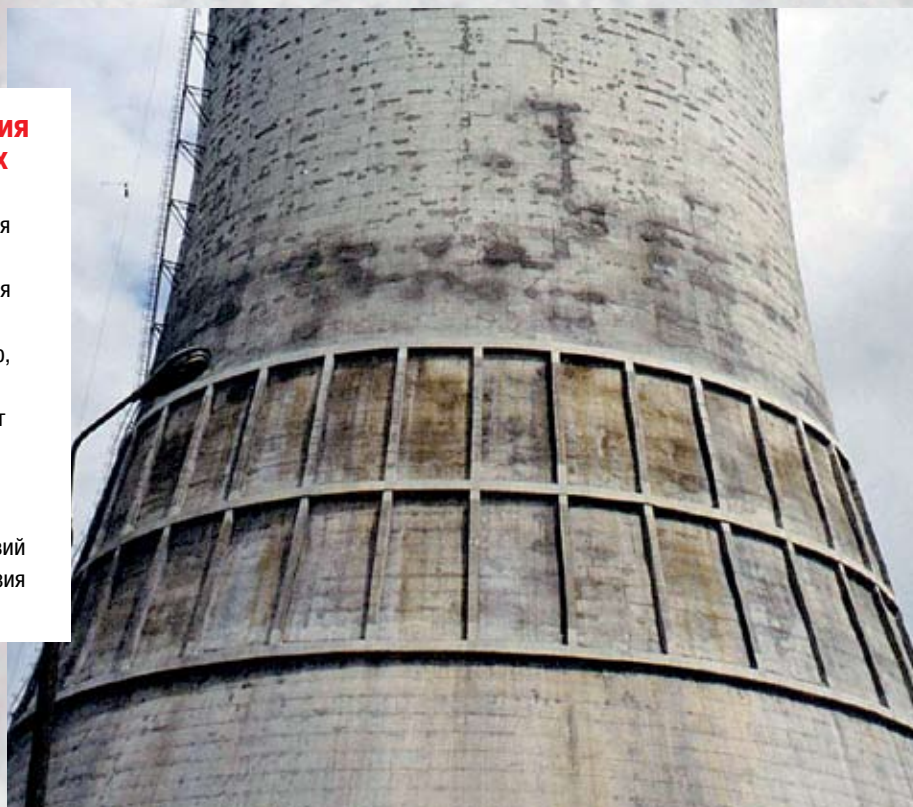
Ускоренная коррозия арматуры и эрозия бетона в зоне воздействий кислых дымовых газов.
