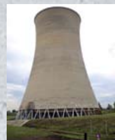
Трещины на бетонной поверхности градирни за более чем 30-летний период эксплуатации.
