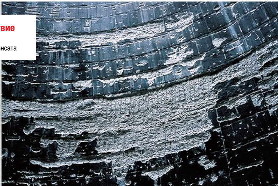
Сильная коррозия бетона и внутренней стальной арматуры из-за неправильного использования ремонтных материалов.
